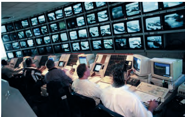
Abb. 1: Veraltetes CCTV Überwachungssystem nach dem Sensor-Monitoring-Prinzip.
