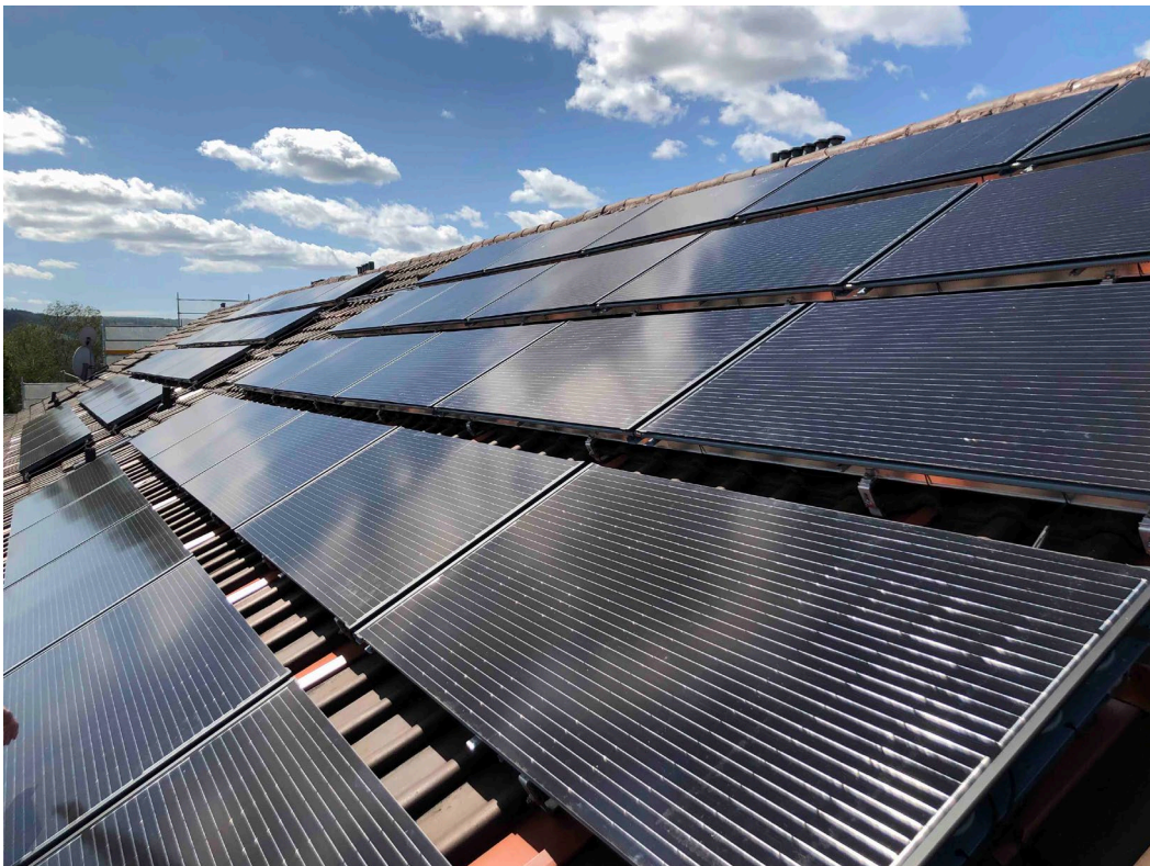
Abbildung 9: Auf dem Dach installierte SOLINK-Kollektoren (eine Dach- und Feldhälfte)
