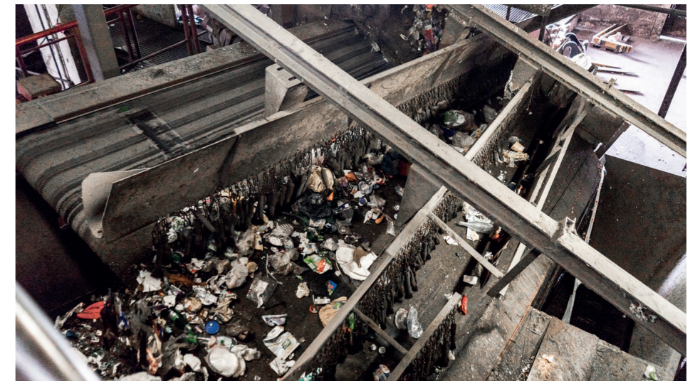
Abb. 3: Schrägsortierband zur Trennung von flächigen und rollenden Verpackungen in einer Sortieranlage.
