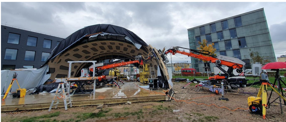
Abbildung 1: Baustelle der livMatS Biomimetic Shell in Freiburg mit robotischem Totalstationsnetzwerk, Aufnahmetisch, und zwei Vor-Ort-Montagemanipulatoren.
